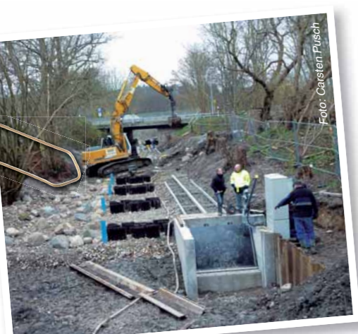
Auch die vielfach wünschenswerte Wiederherstellung der Durchgängigkeit an den Fließgewässern stellt zunächst einen erheblichen Eingriff ins Ökosystem dar: hier der Bau der Sohlgleite Spitzenort, Schwentine, Krs. Plön.
